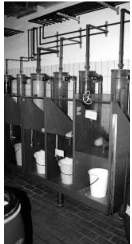
Sicher und genau: Dosieranlage.
